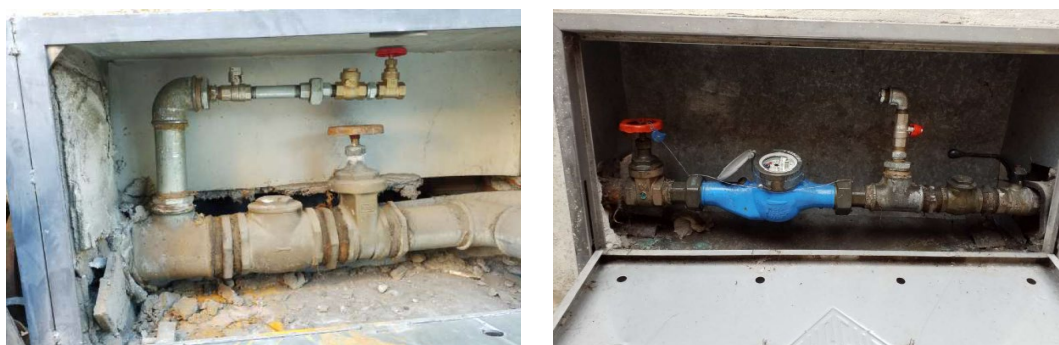
Figura 6 – Predisposizione presa in carico su utenza antincendio (sinistra) e contatore utenza domestica (destra)
